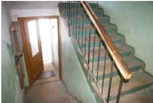
Būve ar kadastra apzīmējumu 6442 001 0030 001, koplietošanas telpa
