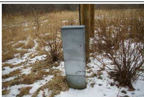
Zemes gabals ar kadastra apzīmējumu 6452 012 0188, elektropievads
