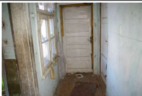
Būve ar kadastra apzīmējumu 6405 010 0158 002, koplietošanas telpa
