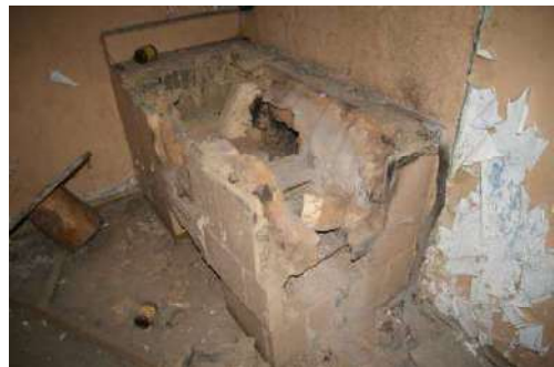
Būve ar kadastra apzīmējumu 6405 010 0158 001, dzīvoklis Nr.20, telpa Nr.1, plīts
