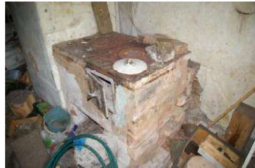
Būve ar kadastra apzīmējumu 6405 010 0158 001, dzīvoklis Nr.18, telpa Nr.3, plīts
