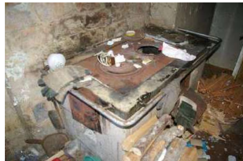
Būve ar kadastra apzīmējumu 6405 010 0158 001, dzīvoklis Nr.17, telpa Nr.1, plīts
