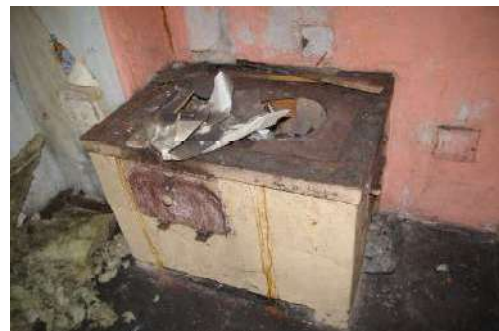
Būve ar kadastra apzīmējumu 6405 010 0158 001, dzīvoklis Nr.16, telpa Nr.3, plīts
