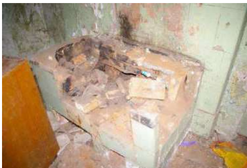
Būve ar kadastra apzīmējumu 6405 010 0158 001, dzīvoklis Nr.19, telpa Nr.3, plīts
