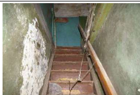
Būve ar kadastra apzīmējumu 6405 010 0158 002, koplietošanas telpa
