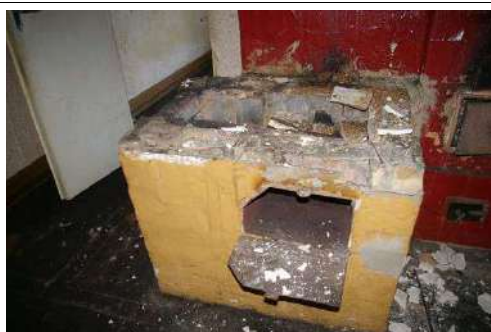
Būve ar kadastra apzīmējumu 6405 010 0158 001, dzīvoklis Nr.21, telpa Nr.1, plīts
