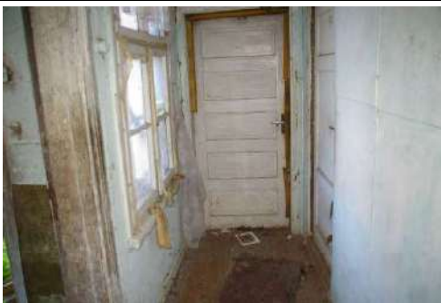
Būve ar kadastra apzīmējumu 6405 010 0158 002, koplietošanas telpa
