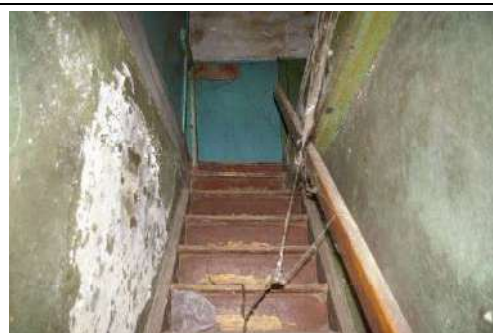
Būve ar kadastra apzīmējumu 6405 010 0158 002, koplietošanas telpa
