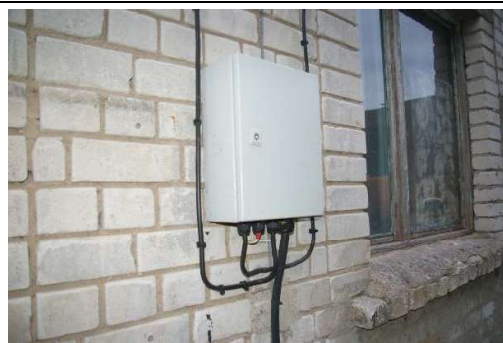
Būve (katlu mājas ēka) ar kadastra apzīmējumu 6427 002 0244 001, elektroapgāde
