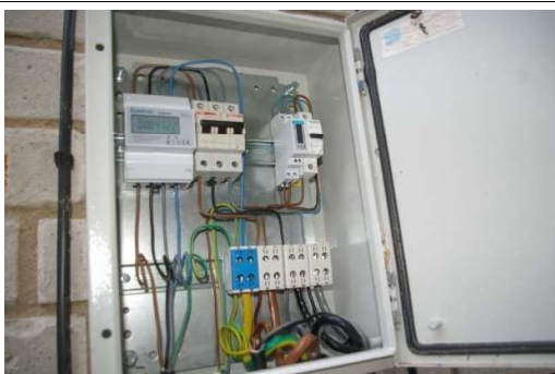
Būve (katlu mājas ēka) ar kadastra apzīmējumu 6427 002 0244 001, elektroapgāde (nav tiešs pieslēgums AS Sadales tīklam)
