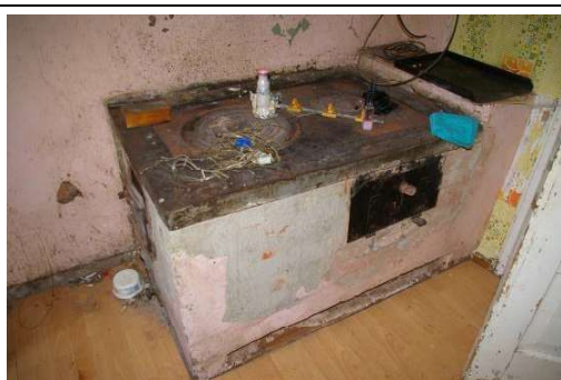
Būve ar kadastra apzīmējumu 6442 001 0026 001, dzīvoklis Nr.5, telpa Nr.2, plīts
